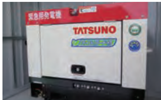
給油所に設置された発電機
