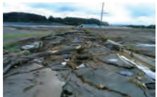
河川氾濫により破壊された道路
