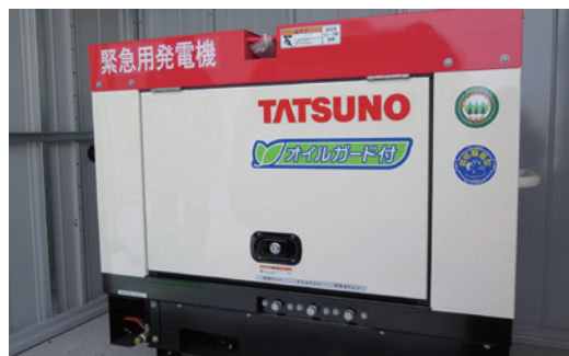
給油所に設置された発電機
