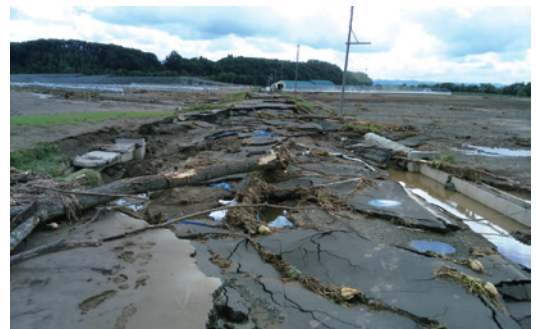
河川氾濫により破壊された道路
