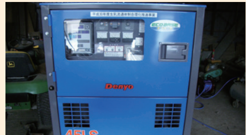
各酪農家へ設置されている発電機
