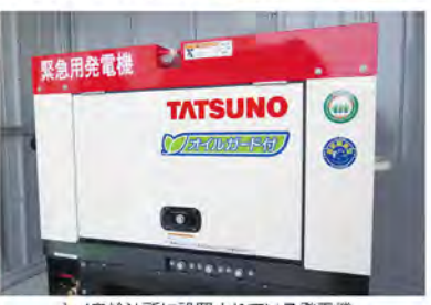
中ノ島給油所に設置されている発電機
